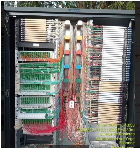
Armoire PM du réseau Sequantic sur Saint-Michel-sur-Orge, remise en état par Altitude Infra en novembre 2023.
